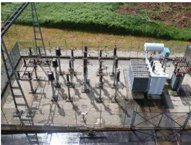
Subestación eléctrica de EnergyWorks
